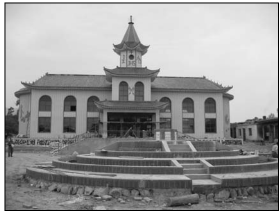
Katholische Kirche mit Gemeindezentrum in Songshu, Diözese Lanzhou, Provinz Gansu (im Bau). Foto: M. SCHILD.
